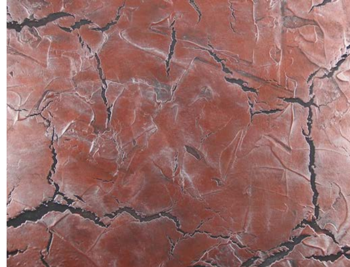
MATERIX SPACCANTE rozpraskaná stěna
